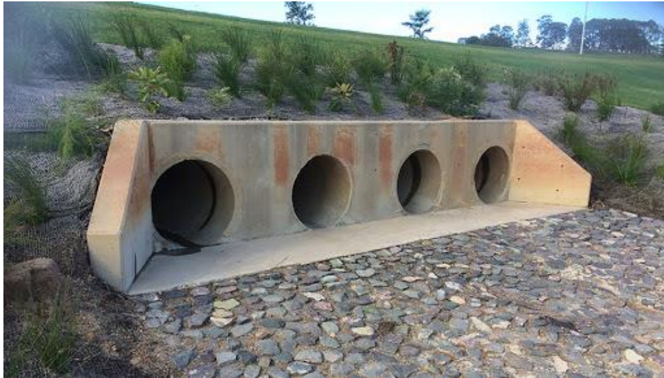
Εικόνα 2: Οχετοί παράλληλα τοποθετημένοι (τετράδυμοι κυκλικοί οχετοί).
